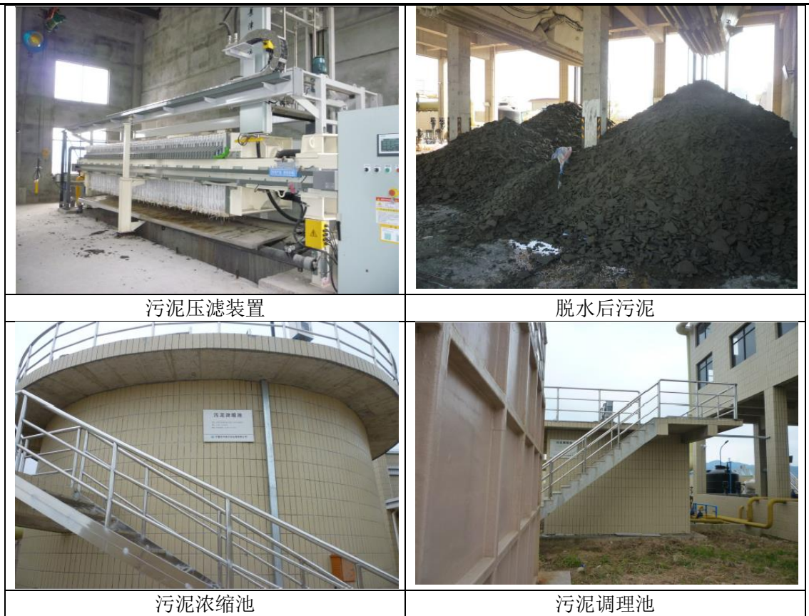
图 2.5-4 现场固废处理设施
